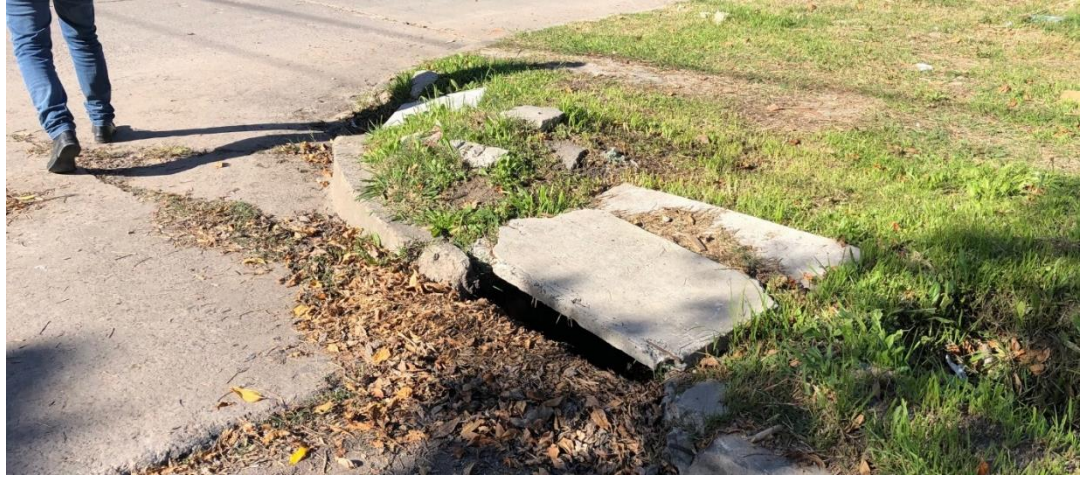
Fotografía I-1: Sumidero esquina 162N y 16
