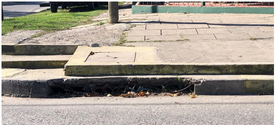
Fotografía I-3: Sumidero esquina 164 y 18
