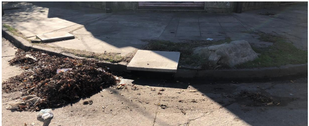
Fotografía I-2: Sumidero esquina 162N y 16
